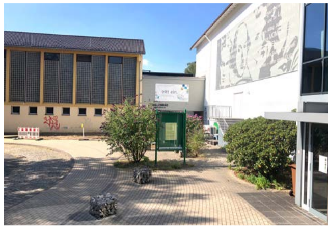
Ein letzter Blick auf den Ist-Zustand – die Abrissarbeiten haben begonnen. Wir freuen uns auf den Kulturellen Marktplatz in Dahlbruch.
